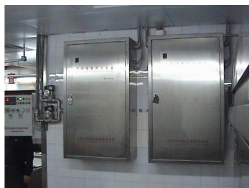
(图 2 厨房灭火系统灭火剂安放柜)
